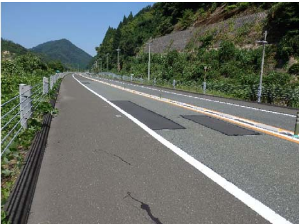
《舗装損傷状況》
