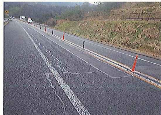
《舗装損傷状況》
