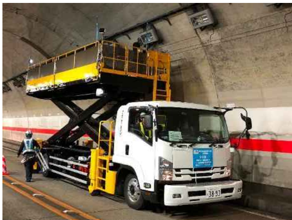
《設備清掃・点検》
